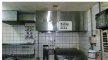
施工した設備
